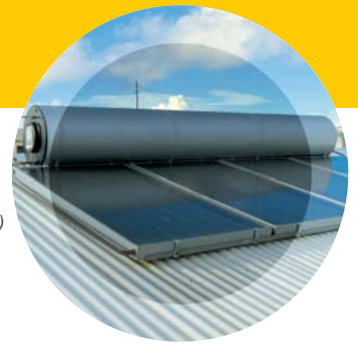
Chauffe eau solaire à Grande Terre (Guadeloupe)
